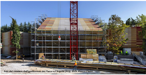
foto del cantiere dell'auditorium del Parco a TRQUIRS (AO), arch. Renzo Piano
